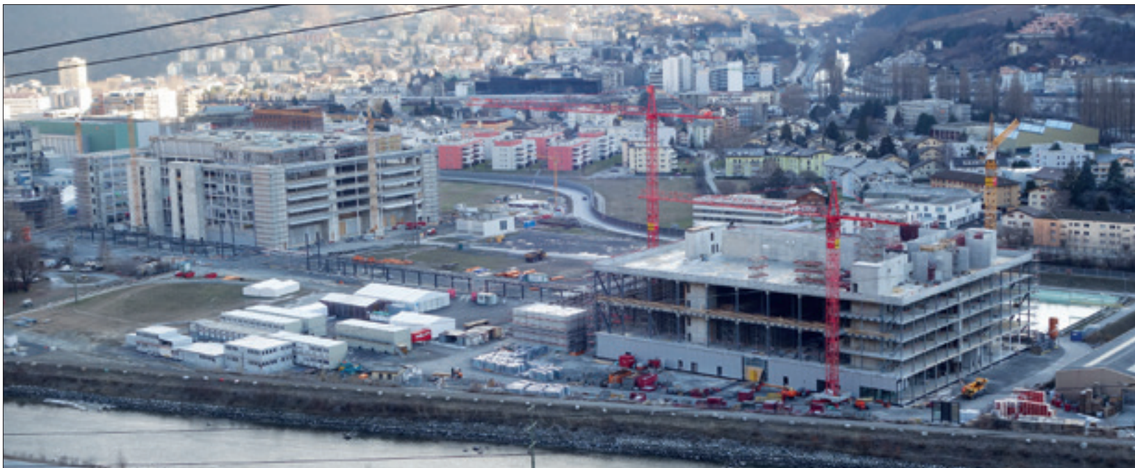
Zwei der fünf vorgesehenen Bauten für die Biologika-Produktion im Westen der Lonza Werke sind an Neujahr 2019 beachtlich weit gediehen.
