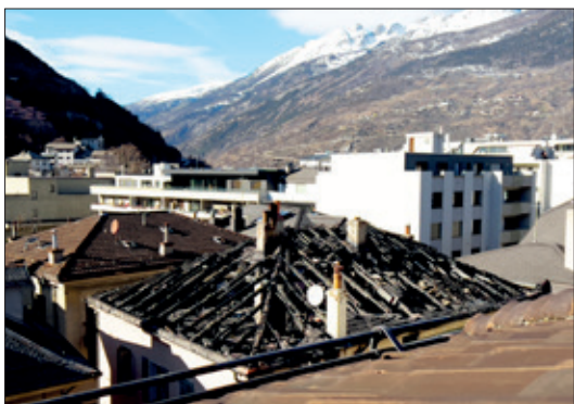
Ausgebrannter Dachstock im Wohnhaus Bahnhofstrasse 27. Bild: vaz
